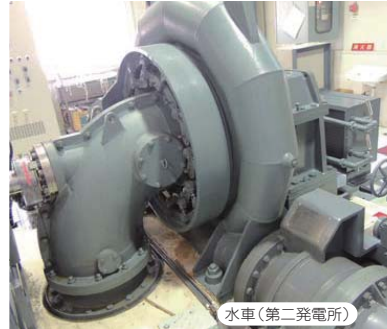
水車(第二発電所)
