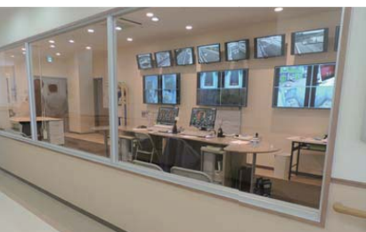
コンピュータ・監視モニターのある中央制御室
