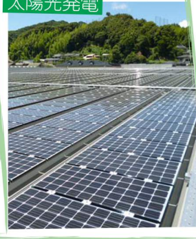
太陽光パネルによる屋根焼け防止で、空調効率もUP
